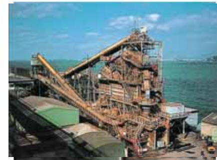
複合路盤材製造装置
