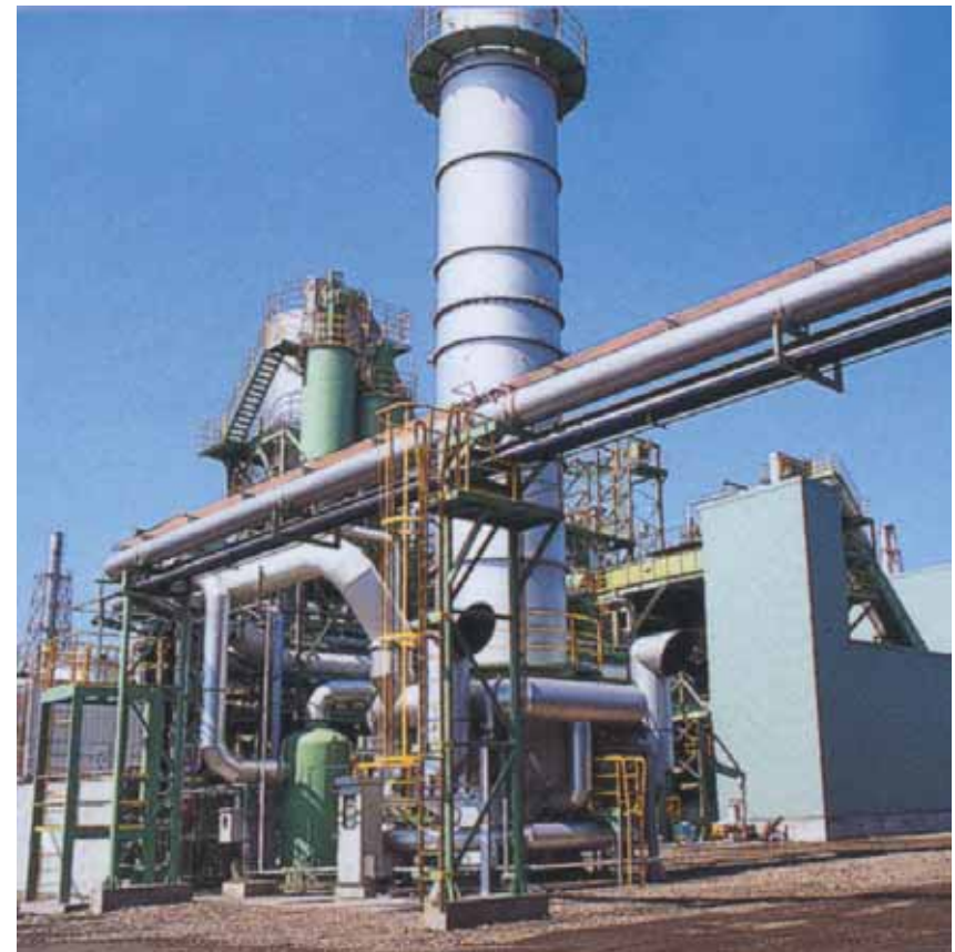
ガス化溶融炉
