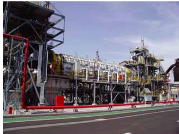
【ガス化リサイクル炉】
