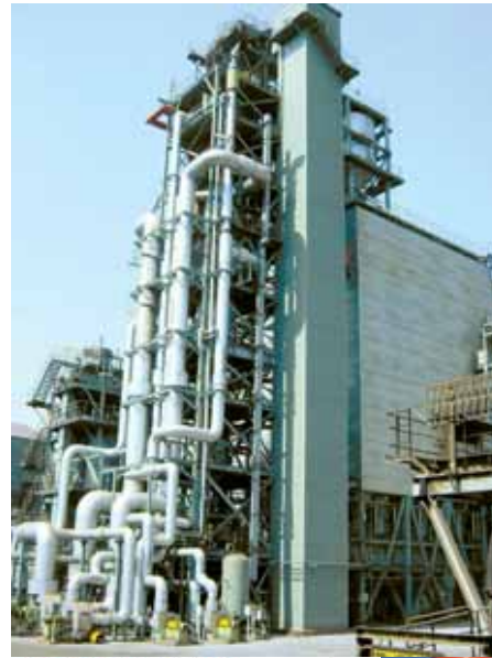
排ガス処理設備
