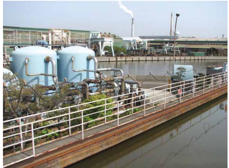
排水処理設備
