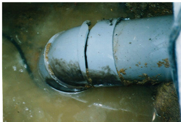
塩ビ管継手部のクラック
