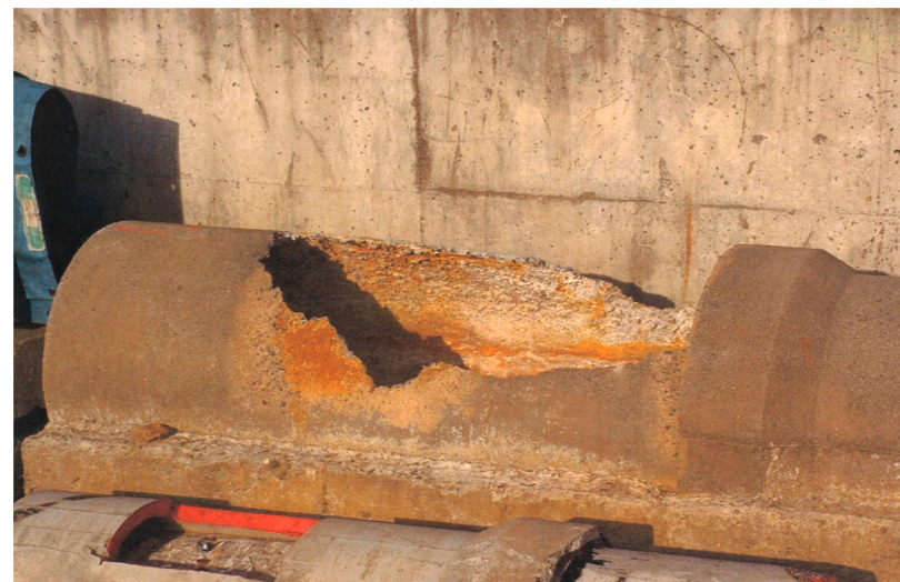
腐食による破損
