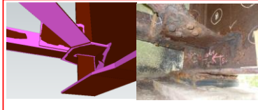
下横構ガセットの腐食
