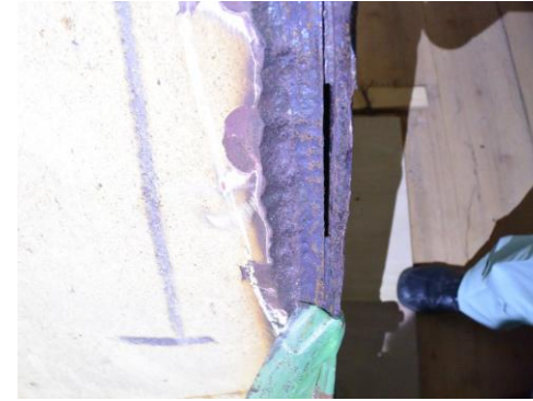
トラス斜材の溶接部の腐食
