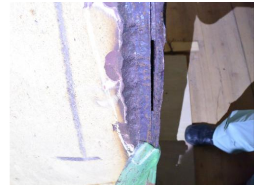
トラス斜材の溶接部の腐食
