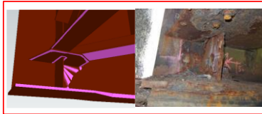
支点上補剛材の腐食
