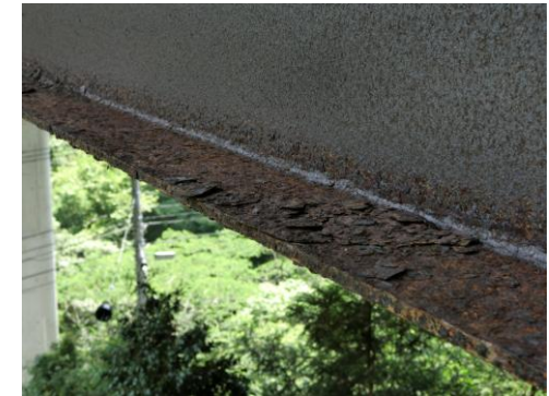
I桁橋下フランジの腐食
