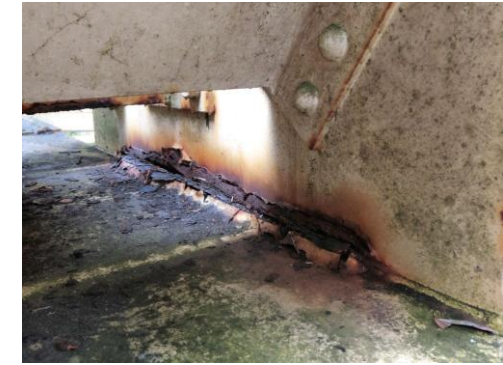
トラスガセット部の腐食
