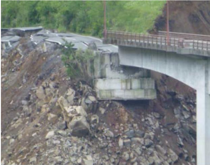
地震による斜面崩壊によって 沈下した橋台
