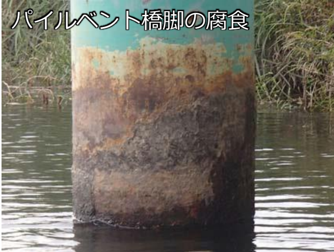
パイルベント橋脚の腐食、断面欠損
