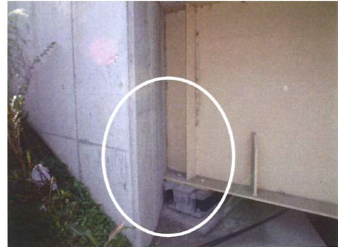
桁とパラペットの接触
