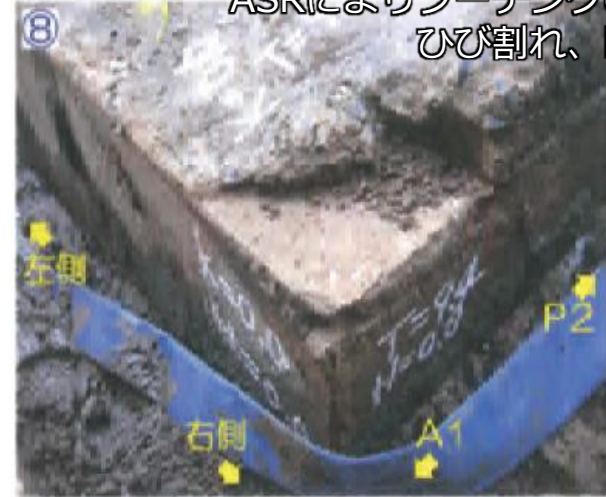
ASRによりフーチングの 上面鉄筋の破断
