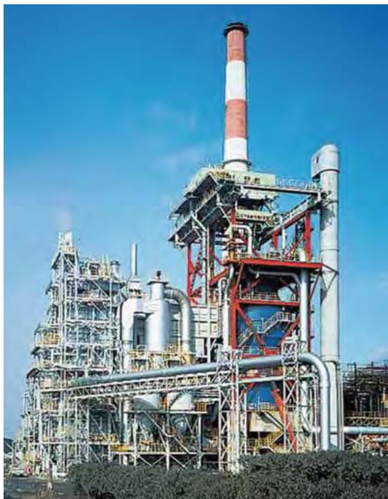
CDQ（コークス乾式消火設備）
