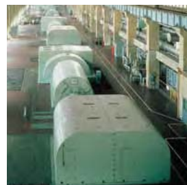
自家発電設備
