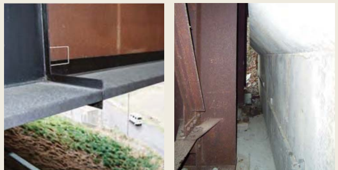
対策事例 (左:水切り板、右:バラベット切欠き)
