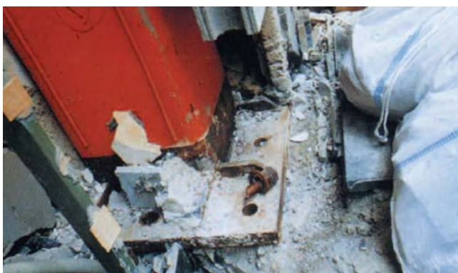
写真4: 鉄骨柱脚部のアンカーボルトが破断して柱がずれています。
