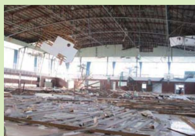
写真5: 天井材が落下している状況です。
