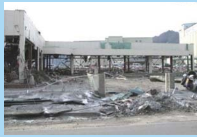
写真7: 1F外装材の流出、ブレースの破断が観られますが建物は残存しています。
