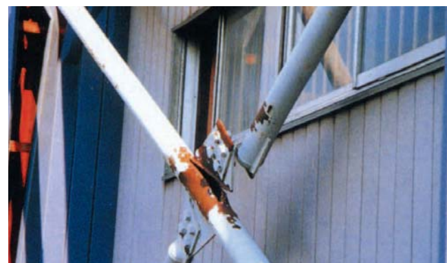
写真3: プレースの接合部が早期に破断しています。
