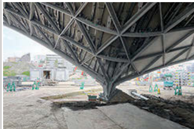
大屋根広場の屋根の着地点。ベースプレートが角度を付けて置かれている
