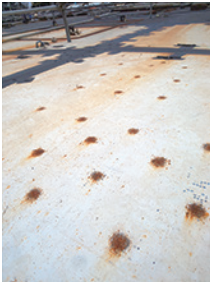
屋根の鋼板の茶色の点は熱で矯正した箇所
