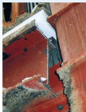
写真2: 梁端部が十分変形する前に溶接部で破断を生じています。
