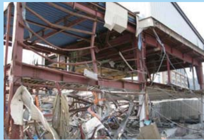
写真8: 漂流物の衝突により間柱が変形していますが、骨組は残存しています。
