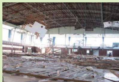
写真5: 天井材が落下している状況です。
