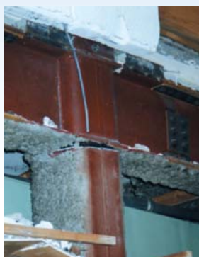
写真1: 溶接不良により、コラム端部の溶接部で破断しています。
