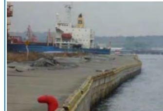
被災事例（岸壁のはらみ出し）
