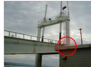
可動橋被災箇所
