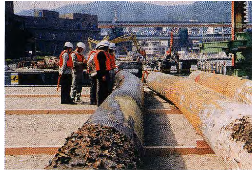
杭式横栈橋の杭の被害(神戸港高浜埠頭、現場にて引き抜き調査の状況)
